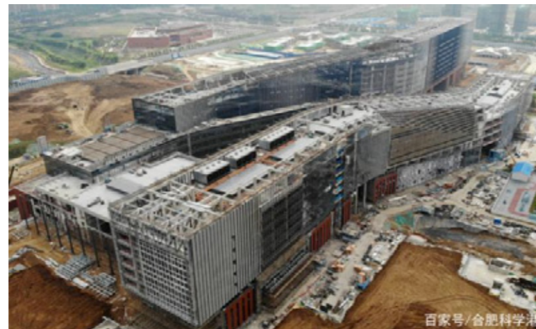
■ Le centre de recherche sur les applications et les technologies quantiques à Hefei en cours de construction
